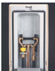
Kulový kohout před vodoměrem (1/4 otáčky). Odvzdušňovací ventil za vodoměrem. Včetně geotermální sondy (standard).
