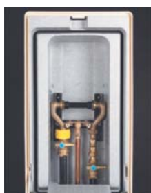
Kulový kohout před i za vodoměrem (1/4 otáčky). Včetně geotermální sondy.
